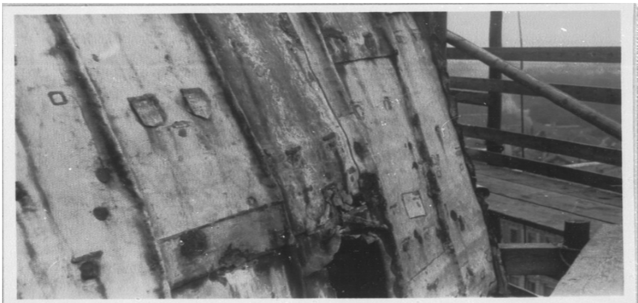
Abb.2: Katholischer Dom Sankt Petrus, Westbau, Osnabrück (1920-1940), stark verwittert und beschädigt
